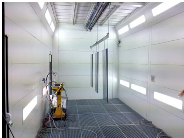
Intérieur cabine à ventilation verticale avec transbordeur Spray booth interior with vertical ventilation, handling with transfer rail
